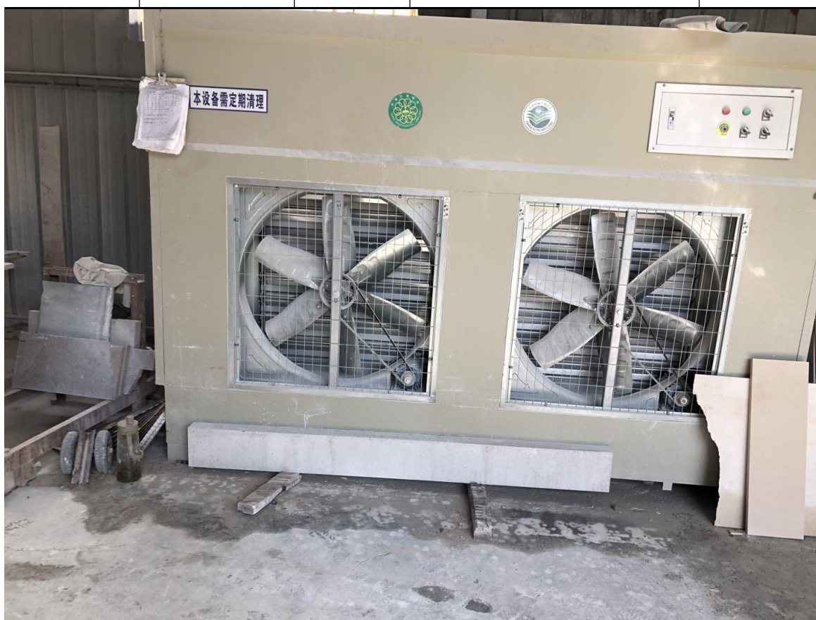
图3-2 废气处理设施
