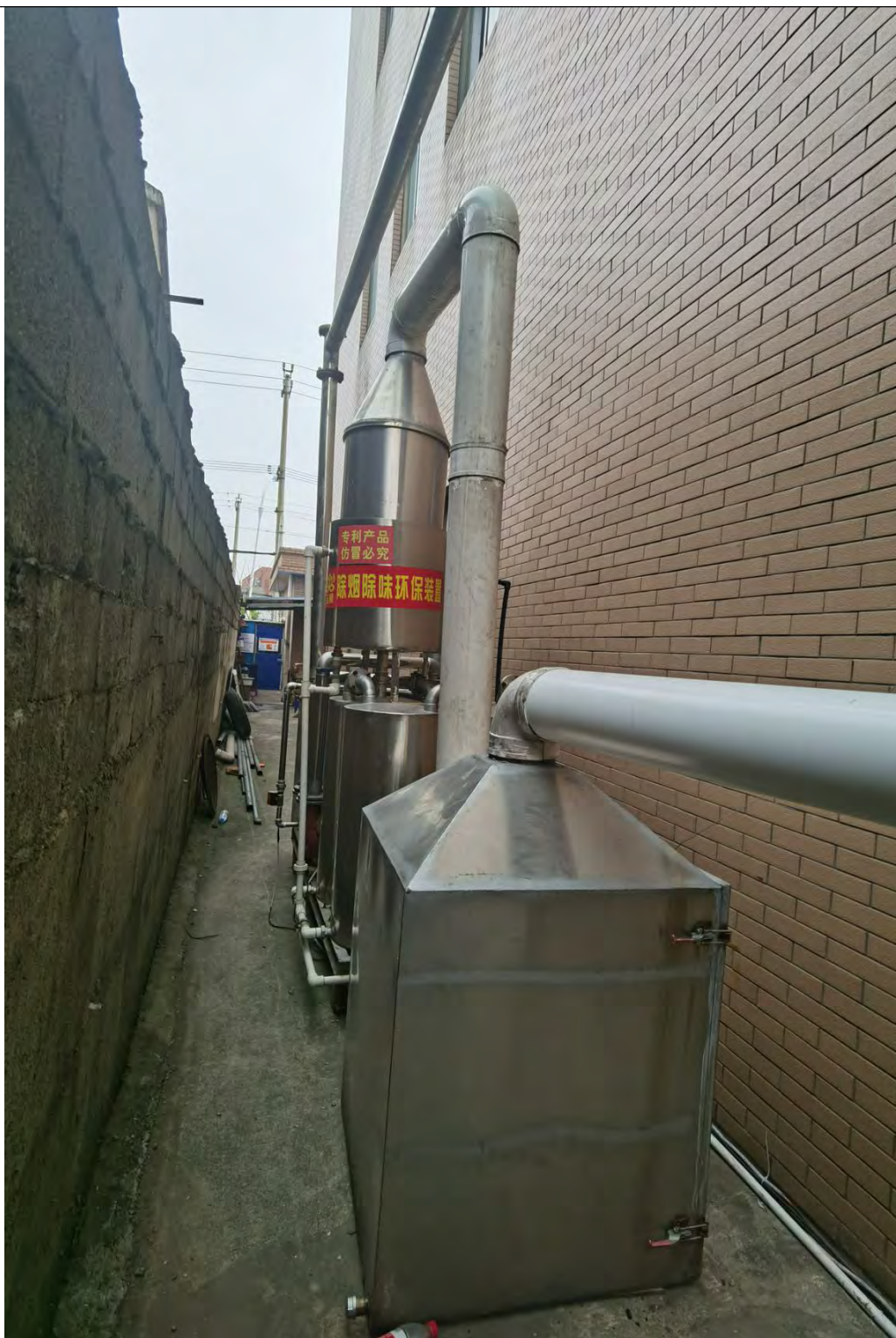
图3-3 废气处理设施
