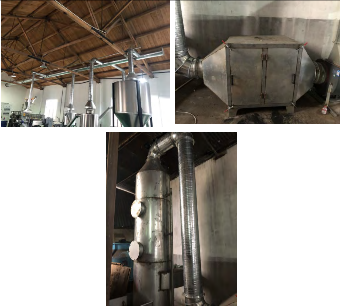
图3-3 废气处理设施
