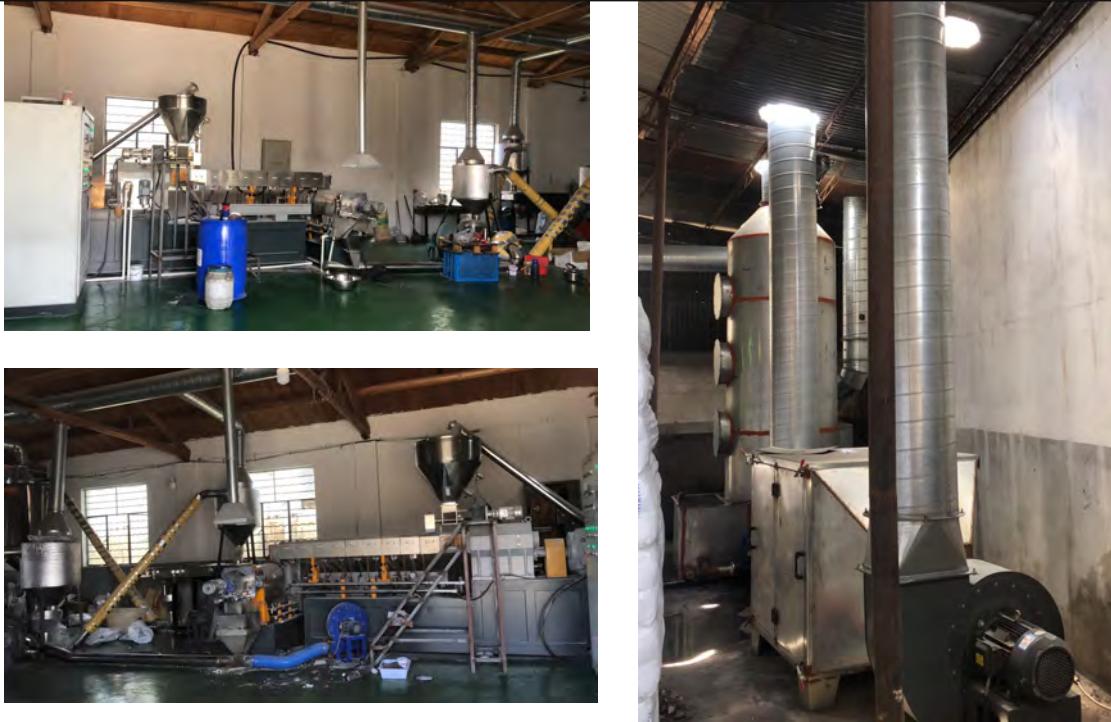
图3-3 废气处理设施
