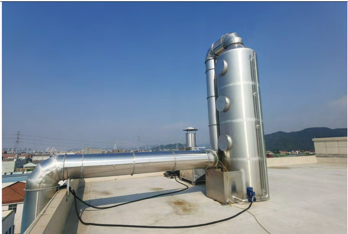
图3-3 废气处理设施
