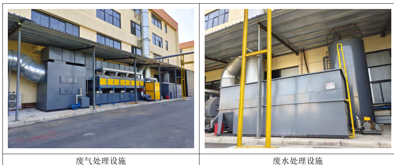
图 4-4 废水、废气处理设施照片
