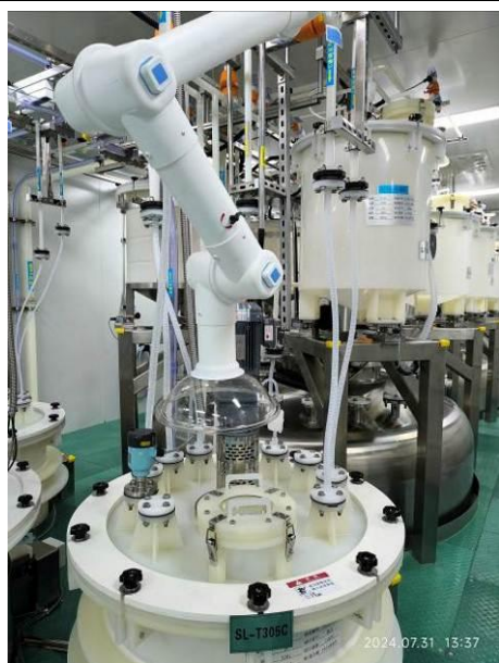
车间九预混釜、成品釜釜口万向上吸风罩
